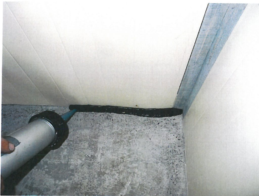
Bild 10 Auftrag InnoElast 2 zur Abdichtung der Fuge zwischen Bodenplatte und Innenseite des Schalungssystems
